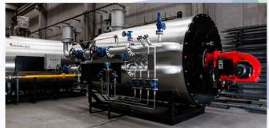
KIZGIN YAĞ TESİSATI
