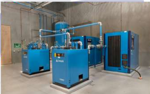
BASINÇLI HAVA TESİSATI
